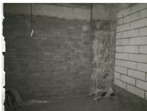
拟建 UNIQ FD20 型 DSA 机房西侧设备室
