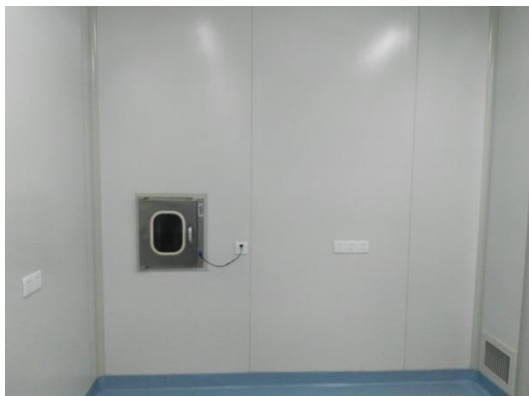
放化室药物过墙传递口
