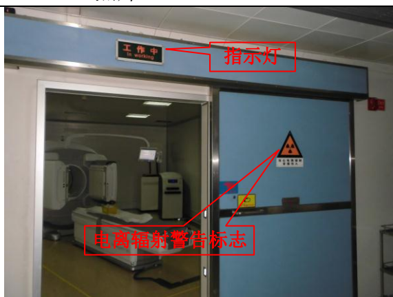
照片 4-3 ECT（一）控制室
