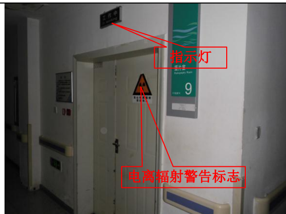
照片 4-66 X 摄片机病人出入防护门
