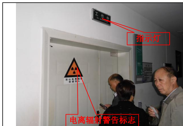
照片 4-63 X 摄片机病人出入防护门
