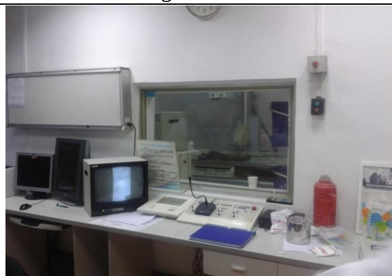
照片 4-84 R100 透视机操作位
