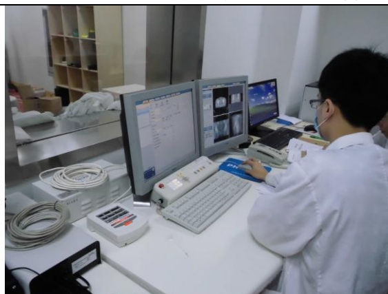
照片 4-110 CT 模拟定位机控制室
