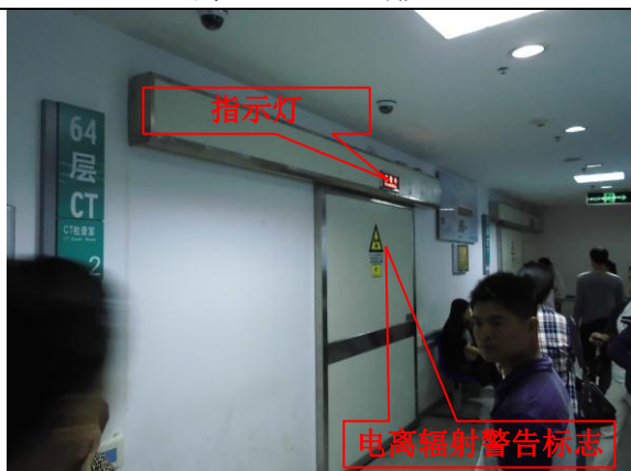
照片 4-57 64 排 CT 病人进出防护门
